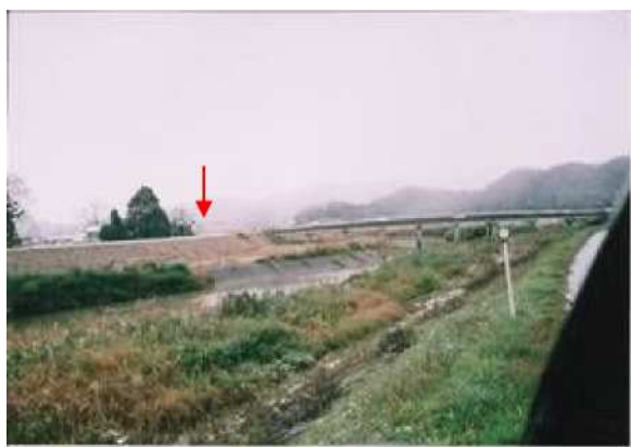
写真1. 破堤した鳥居橋上流左岸(矢印)
