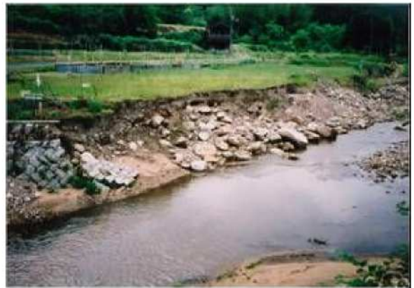
写真10. 流された護岸跡
