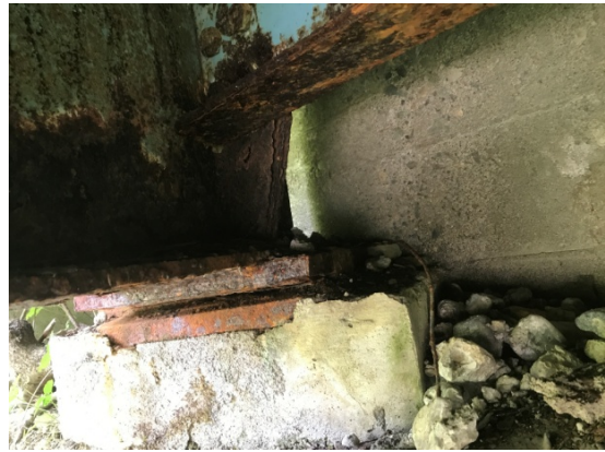
写真 7 腐食が進行し、やや傷んだ金属部材
