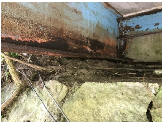
写真 10 橋桁に接触するほど堆積した土砂
