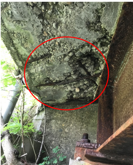
写真 6 施工不良により露出している鉄筋
