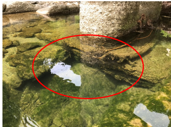
写真 8 洗掘が進み基礎部分が露出した橋脚
