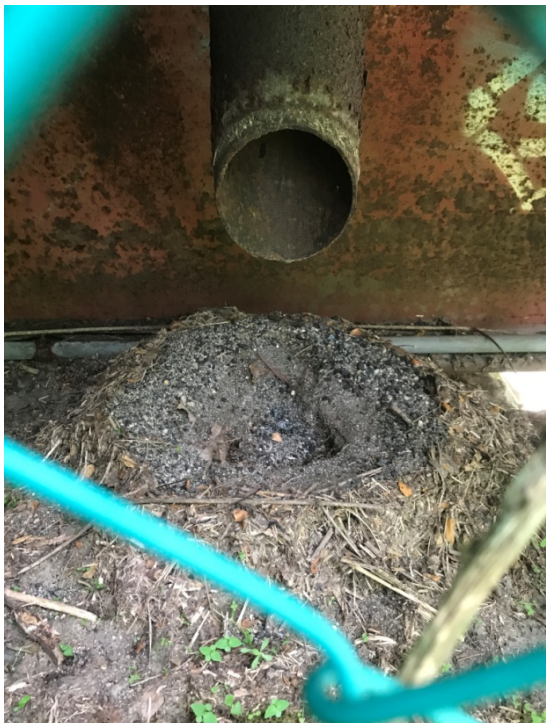
写真 9 排水管を通過し堆積した土砂
